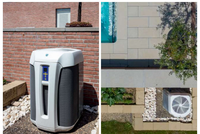
Beheizt wird das Becken von einer Zodiac-Wärmepumpe.
